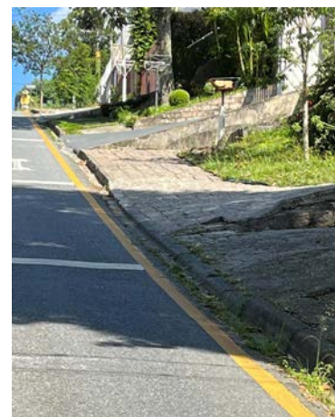
» Figura 25. Calçada com desnível.
