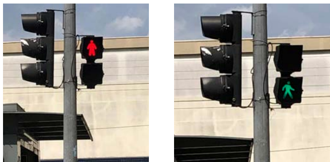
» Figura 6. Semáforo de pedestres.
