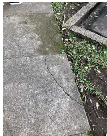
» Figura 24. Calçada com rachadura.
