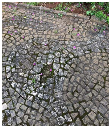
» Figura 23. Calçada com buraco.
