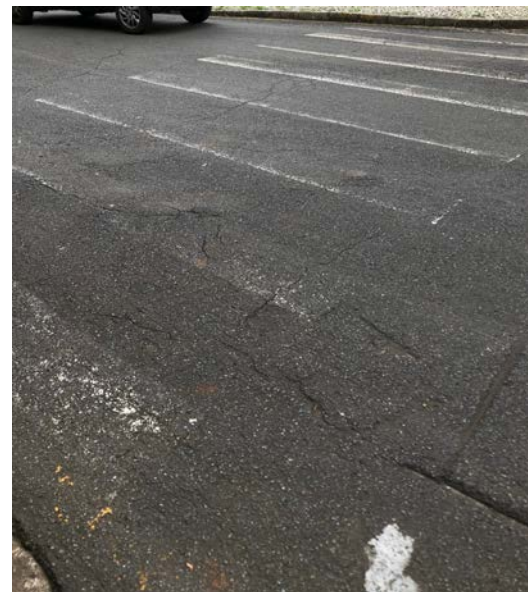
» Figura 21. Faixa de pedestres apagada.
