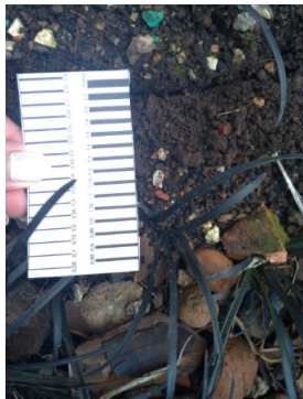
» Figura 11. (A) Registro de trinca no solo. (B) Registro de trinca em parede de alvenaria.
